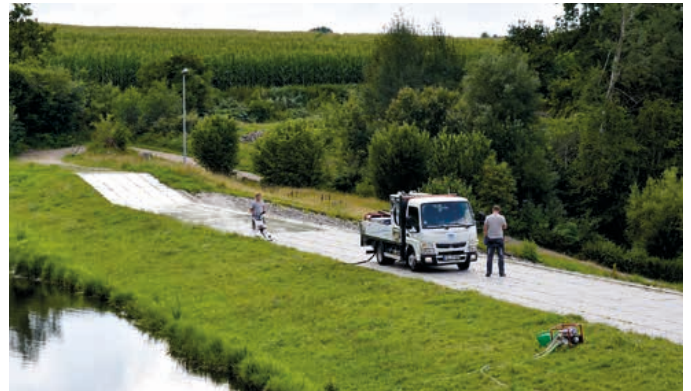
Doppeltherme auf gepflasterten Wegen in Gewässernähe. Hier wird ausschließlich mit heißem Wasser gearbeitet.
